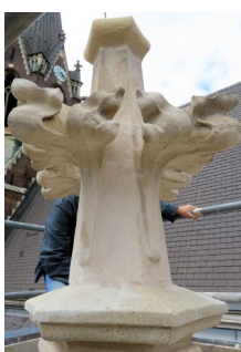
Unsanierter und sanierter Kreuzblume
